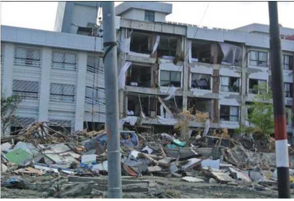
Kedaaan sebuah hotel di Pantai Talise, Palu setelah dilanda tsunami.
